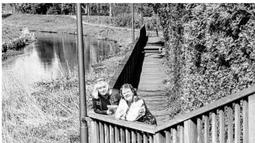
Der Holzsteg an der Varreler Bäche sollte nach Meinung von Leser Wolfgang Bertram saniert werden. Seit der Unterschriftenaktion 2015 sei nichts passiert, meint er. FOTO: WALTER GERBRACHT
